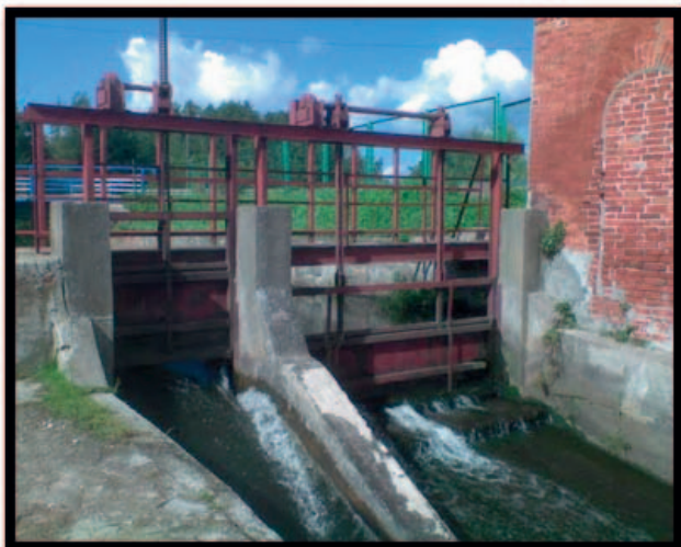
Zdjęcie 8 Elektrownia wodna w Brodzkich Młynach Źródło – mapio.net
